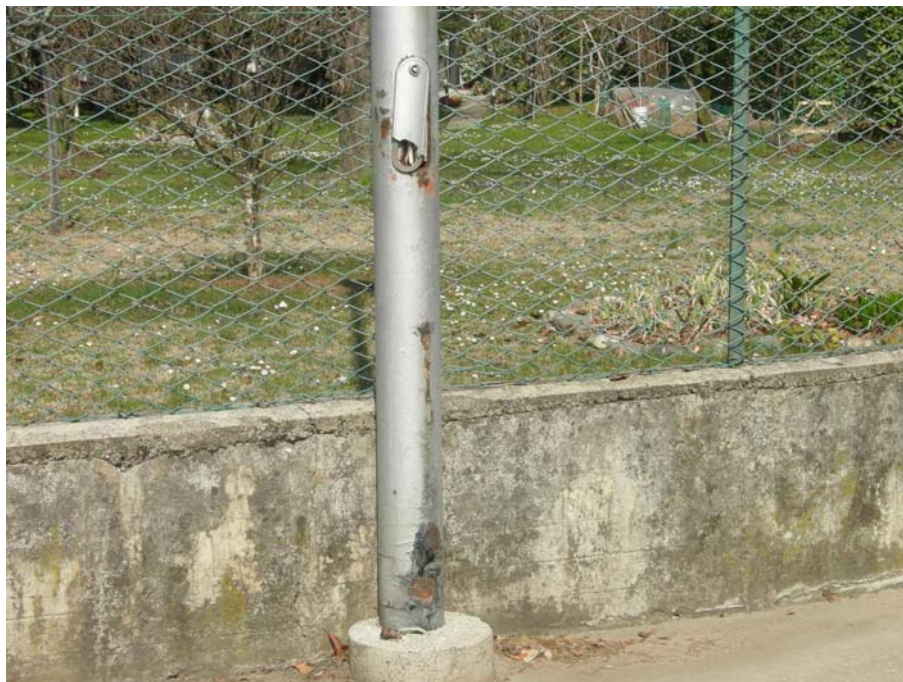
Via Sant'Alessandro: sostegno danneggiato
