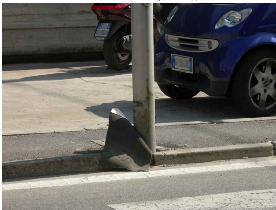
Via San Francesco d'Assisi: palo in acciaio danneggiato alla base
