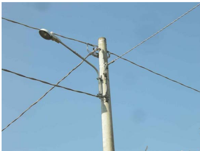
Via Dei Mulini: giunzioni di cavi su sostegno in c.a.c.
