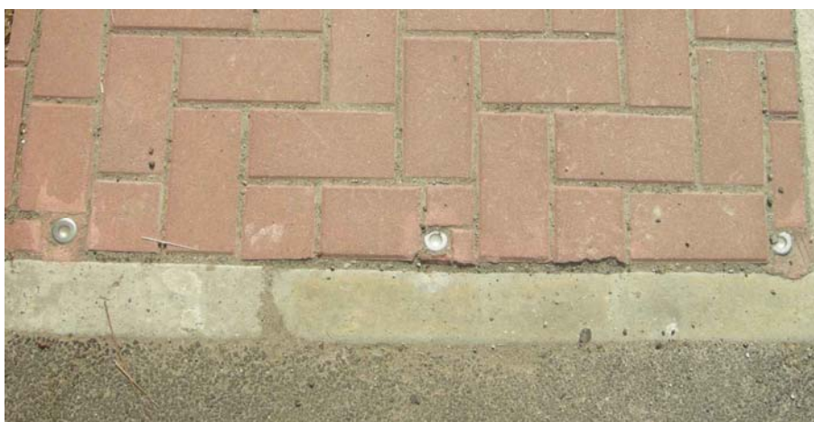
Via Dei Tigli: apparecchi ad incasso segnaletici con sorgente a LED posti lungo il marciapiede
