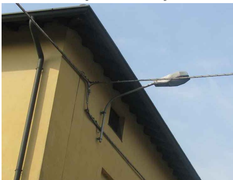
Via Dei Novelli: giunzione di cavi su facciata.
