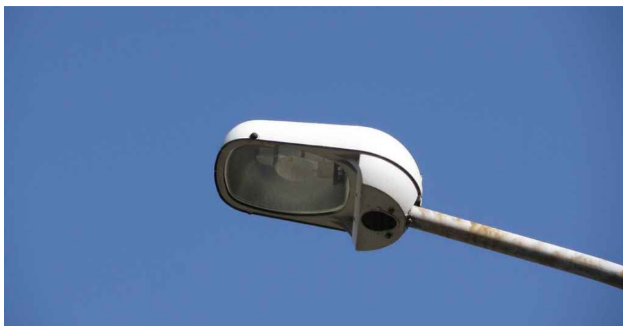
Via Sant'Alessandro: armatura stradale totalmente schermata dotata di vetro di chiusura piano conforme alla L.R. 17/2000 e alla L.R. 38/2004 ed equipaggiata con sorgenti obsolete ai vapori di mercurio non compatibili con le leggi regionali vigenti.
