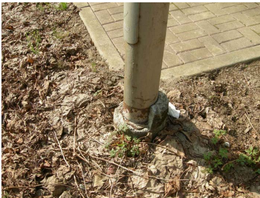
Via Dei Tigli: sostegno con collarino danneggiato
