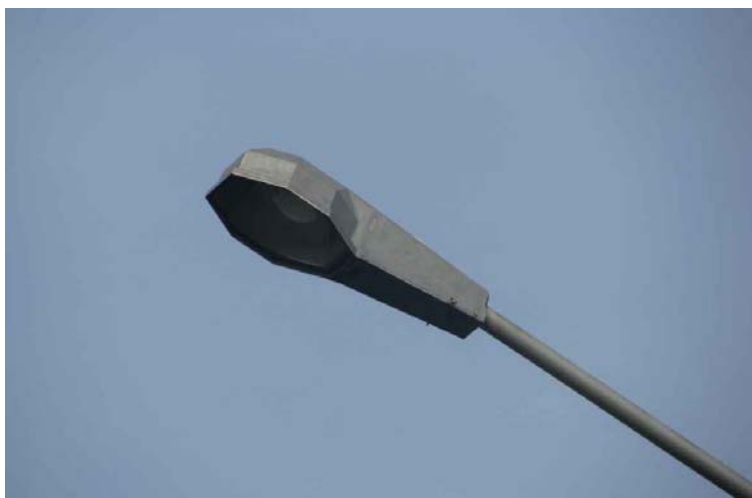
S.P 54: armatura stradale priva di vetro di chiusura, non conforme alle leggi regionali vigenti, ed equipaggiata con sorgenti obsolete ai vapori di mercurio.
