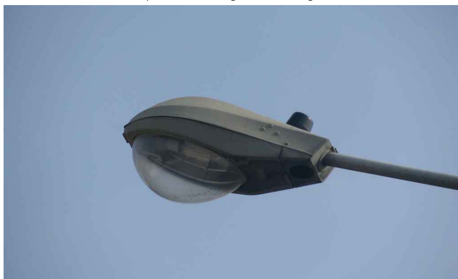
S.P 54: armatura stradale dotata di vetro di chiusura diffondente non conforme alla L.R. 17/2000 e alla L.R. 38/2004.
