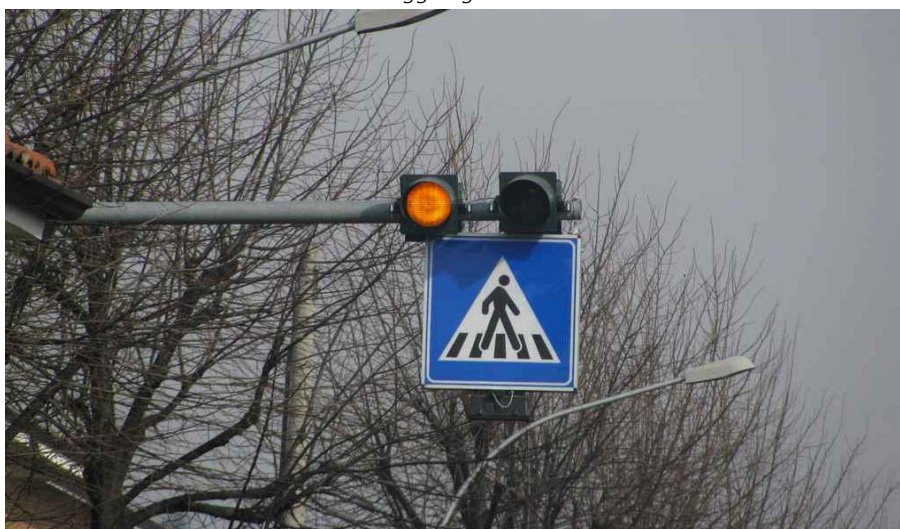
Via Aldo Moro: proiettore per attraversamento pedonale e apparecchi lampeggianti di segnalazione.
