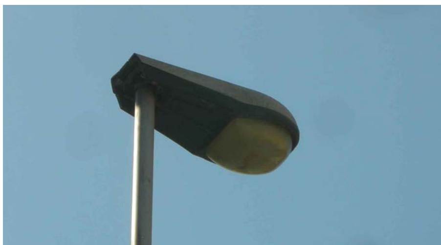
Piazza Della repubblica: armatura stradale dotata di vetro di chiusura diffondente non compatibile con le vigenti norme regionali.
