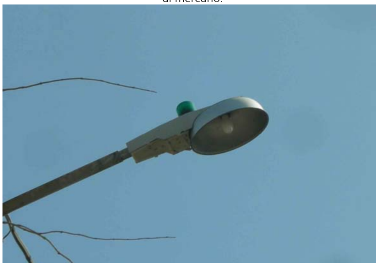
Piazza della Repubblica: armatura stradale priva di vetro di chiusura ed equipaggiata con sorgenti obsolete ai vapori di mercurio non conforme alla L.R. 17/2000 e alla L.R. 38/2004.
